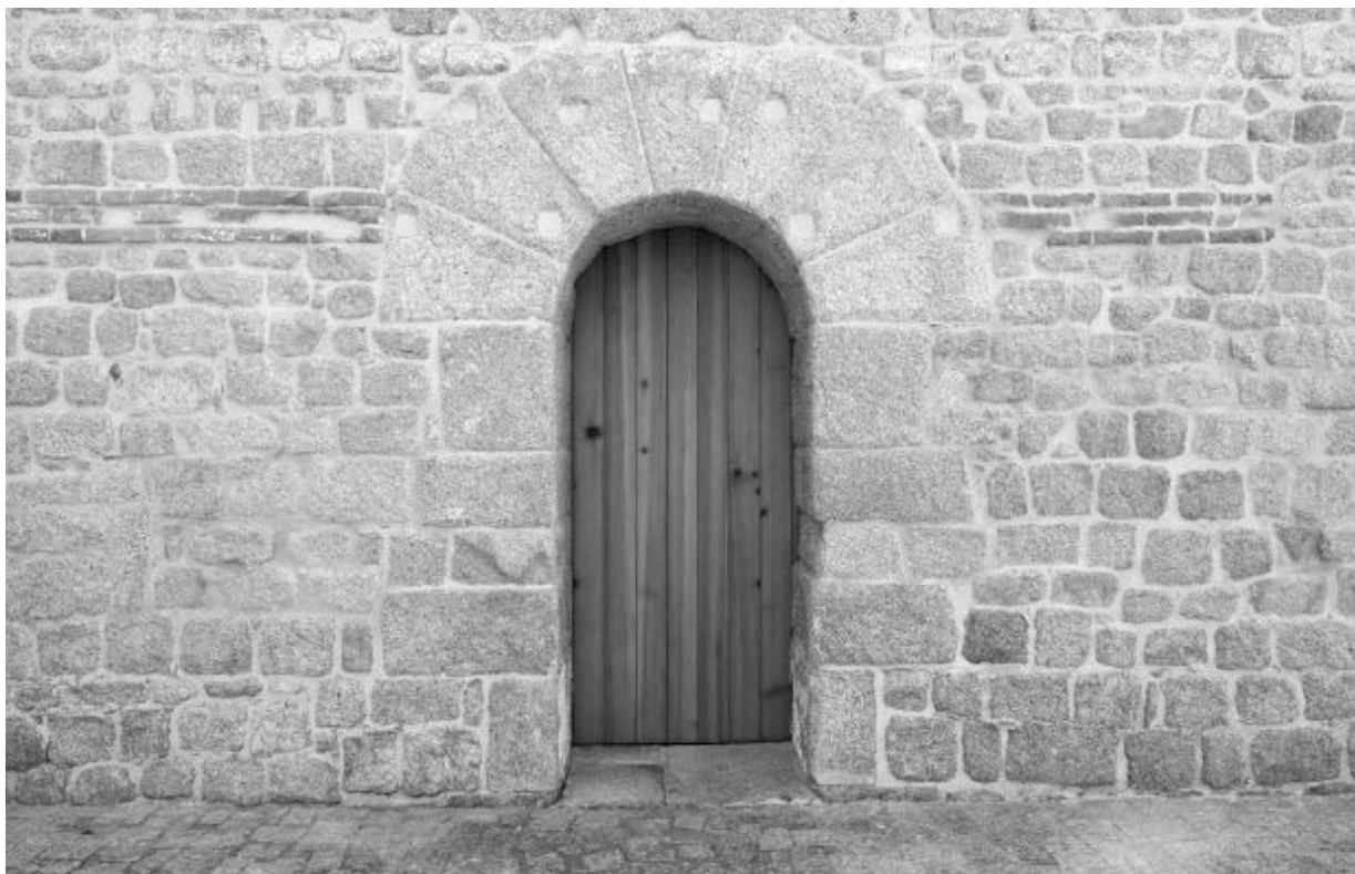
Fig. 9: Porta romana do edifício do edifício da Fase II, após conclusão dos trabalhos de restauro e conservação
