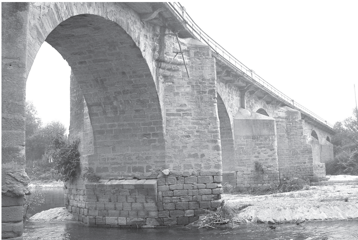
Fig. 4 – A ponte de Vouga, lado de montante, vendo-se em primeiro plano o pilar P6, seguido dos pilares P7 a P10 (fotografia do autor, 2001)
