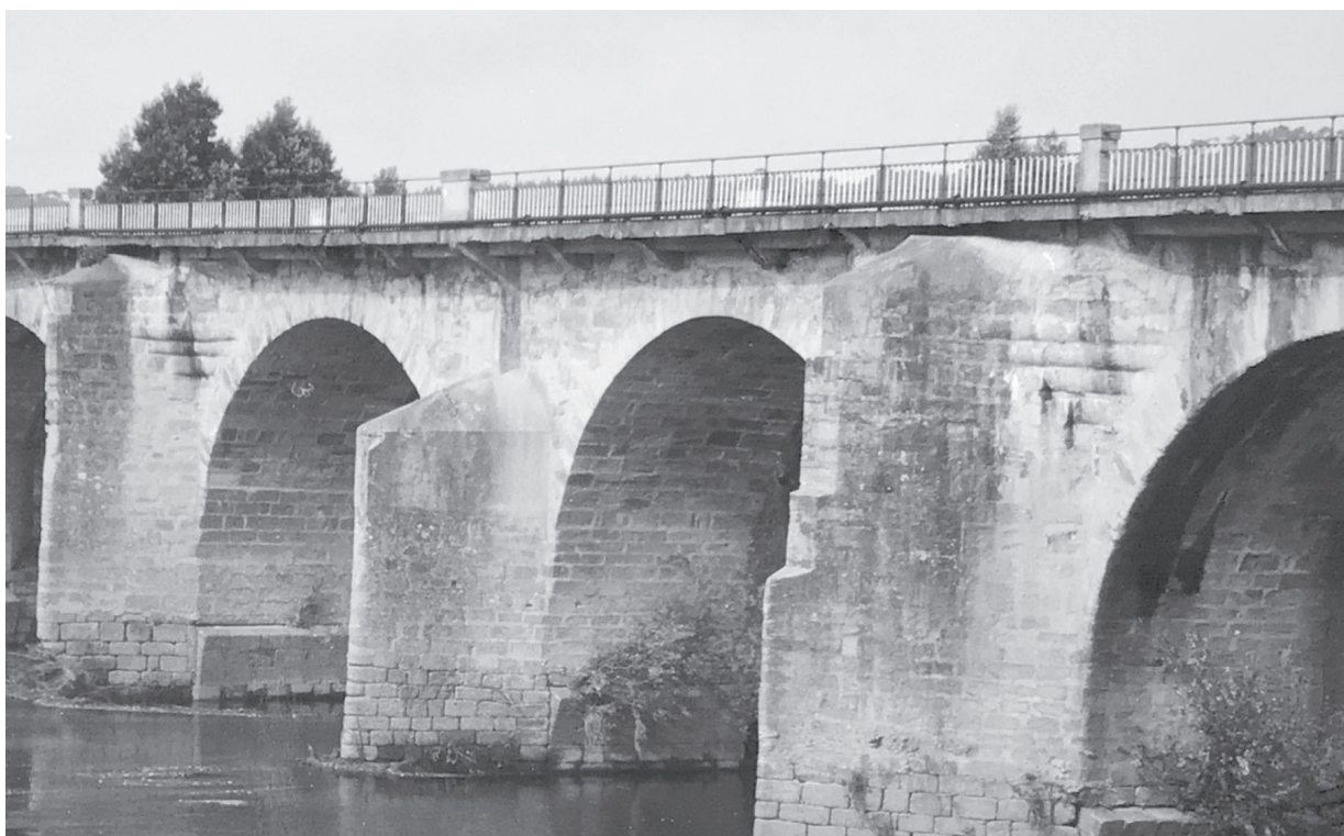
Fig. 3 – Pilares P6, P7 e P8, vistos de montante e margem norte (fotografia do autor, 1999)
