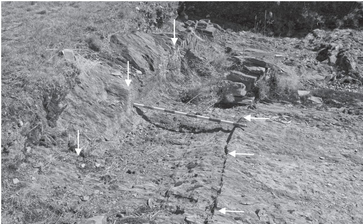
Fig. 15: Chao Samartín. Caja de cimentación del lateral norte de la gran cabaña del recinto superior.
