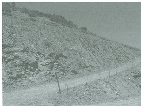
Foto n.º 2 | Ravinamentos nos taludes de uma vinha em patamares (Sobreira, Murça), após precipitação intensa de 7/06/04.
