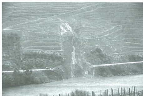
Foto 9 | Fluxo de detritos ocorrido no concelho de Armamar/ Estrada Nacional 222 (Dezembro, 2002)
