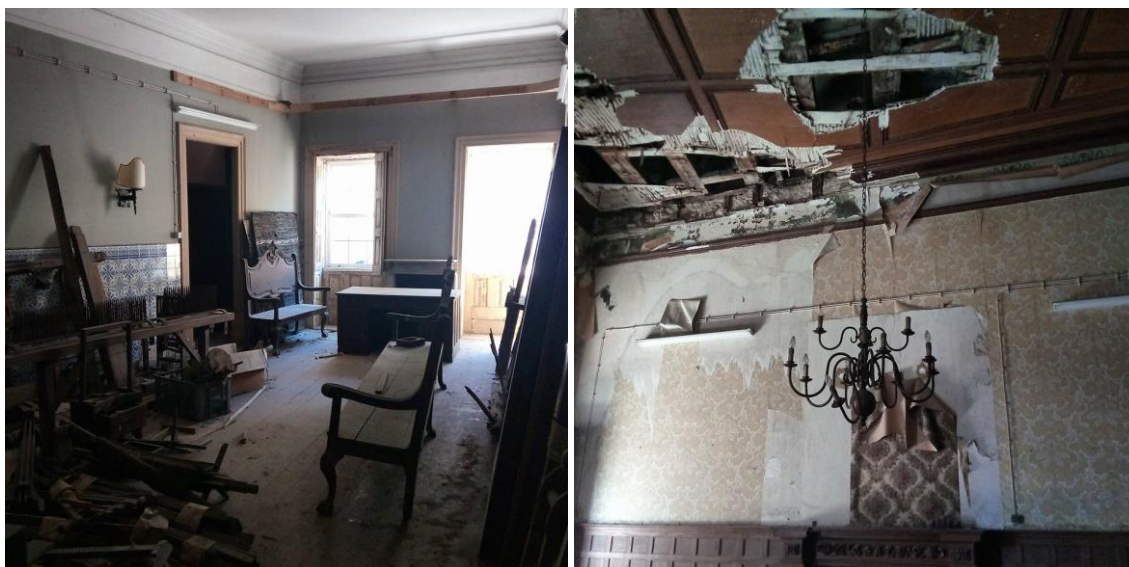
Fotografias 5 e 6 – Objetos ainda no interior do Palácio de S. João Novo e estado do edifício. Do autor.
