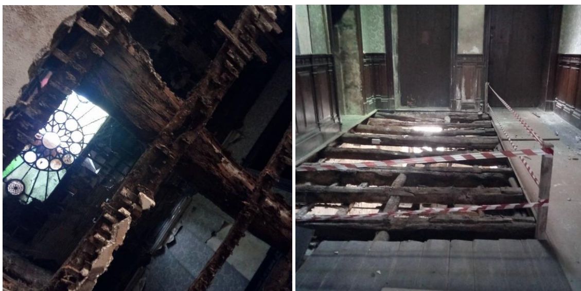
Fotografias 7 e 8 – Aspeto sobre o estado de degradação do Palácio de S. João Novo. Do autor.
